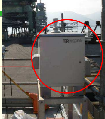
BANCHINA 2 (Skypost CESI)
